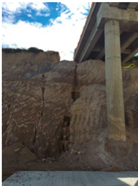
Figura 23 Chimeneas verticales expuestas por la introducción de la infraestructura carretera
